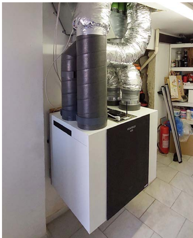
Instalovaná jednotka VENTBOX 400 v technické místnosti
