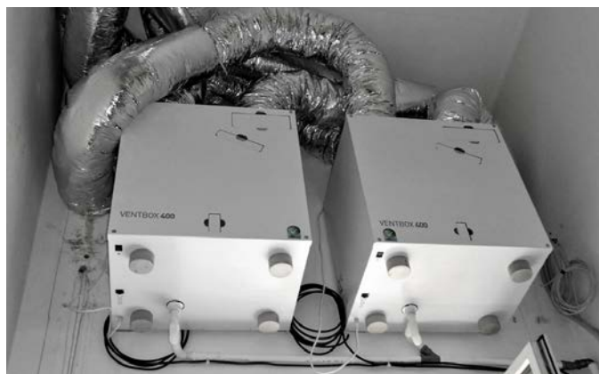
Dvě rekuperační jednotky a část rozvodů (VENTBOX 400)
